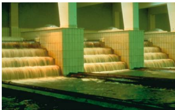
Figuur 22: beluchting en natfiltratie bij pompstation Noord-Bergum (Friesland).
