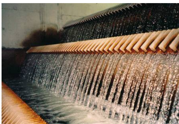
Figuur 30: cascadebeluchting met verdeling in vele stralen bij pompstation Heel (Limburg).
