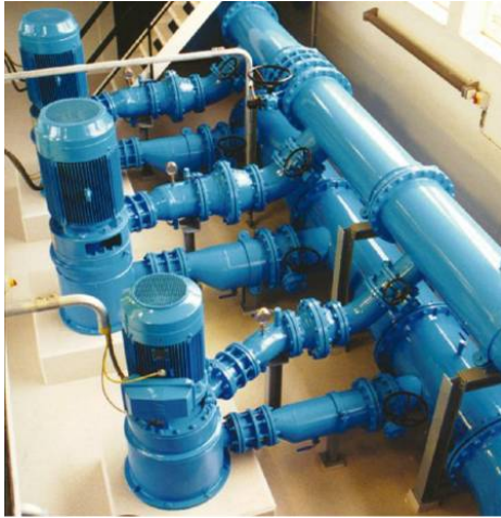
Figuur 42: transportpompen voor drinkwater.
